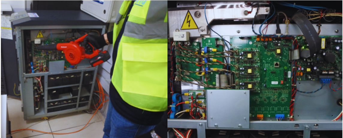
Görsel 4 – UPS Bakım Çalışması
