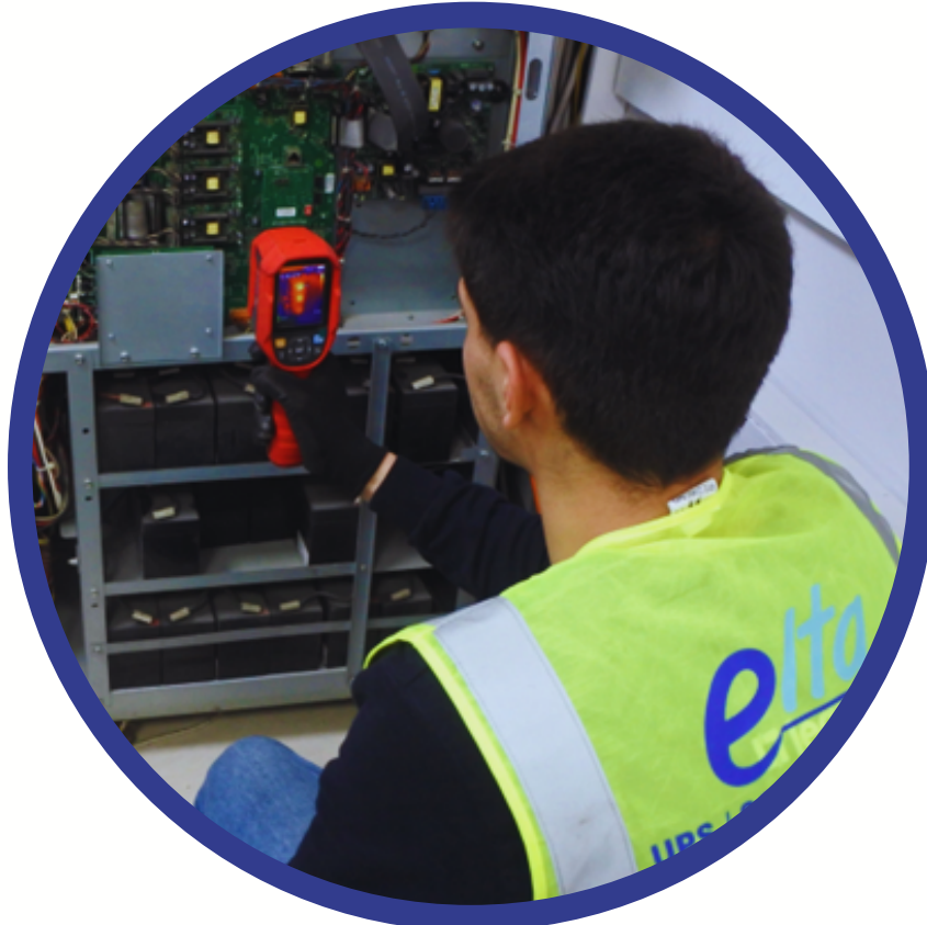
Görsel 8 – UPS bileşenlerinin sıcaklık değerleri termal kamera kullanılarak ölçülmesi
